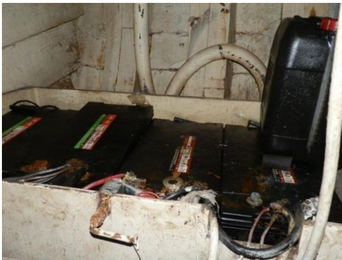
Εικόνα 15: Οι συσσωρευτές ενέργειας (μπαταρίες) στο χώρο του μηχανοστασίου του ΠΑΝΑΓΙΩΤΗΣ Φ
