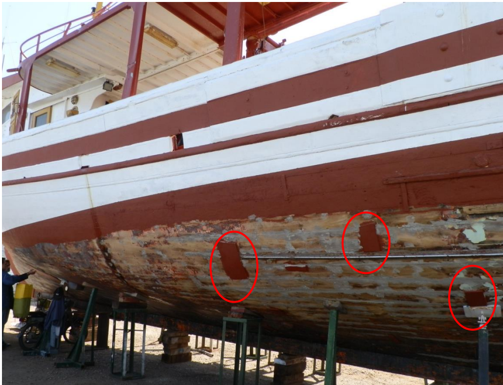
Εικόνα 10: Επισημαίνονται τα σημεία επιθεμάτων στο εξωτερικό περίβλημα του μηχανοστασίου όπου είχαν προκληθεί ρωγμές (οπές) κατά την πρόσκρουση του ΠΑΝΑΓΙΩΤΗΣ Φ στην βραχώδη ακτή.
