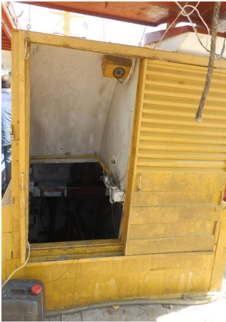
Εικόνα 13: Είσοδος στο χώρο μηχανοστασίου του ΠΑΝΑΓΙΩΤΗΣ Φ
